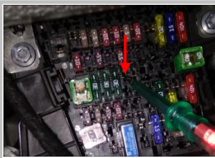
3.21 接正极 (尾门正极和解码器正极): 在驾驶室中控台保险盒预留孔用试电笔测出常电孔位
