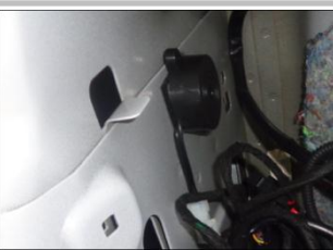
3.33 安装蜂鸣器 ：与 ECU 接头对接，并把蜂鸣器装在装饰板内空旷处；
