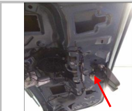
3.13 接门锁线: 拆下原车尾门上盖板后, 看到原车门锁连接器
