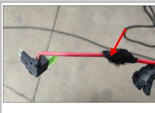
3.8 接正极取电器:取电器用电工胶布捆绑好,并防止松动脱落现象
